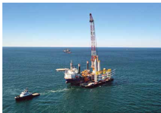
Fester Teil der Flotte von Van Oord: Das Schiff Aeolus zur Offshore-Windpark-Errichtung
