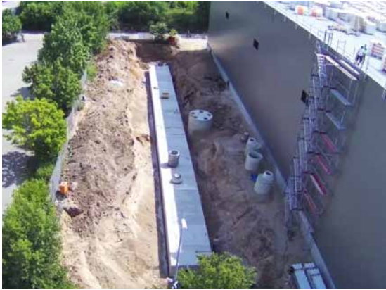
Für das BVH Mannheim hat das Unternehmen die Betonfertigteile geliefert, die Bauleistung übernommen sowie die Regenwasserbehandlungs- und Versickerungsanlagen geliefert
