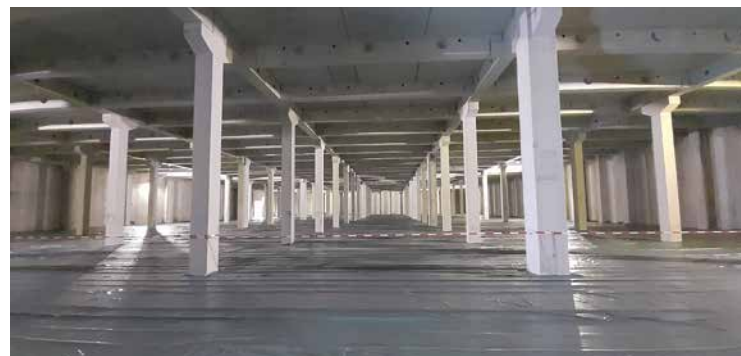
Für die Firma Sonax hat FUCHS ein Projekt mit zahlreichen Fertigteilen in zwei Bauabschnitten gefertigt und montiert. Zum Teil waren hier Mobilkräne mit bis zu 700 t im Einsatz
