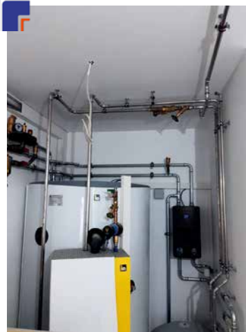
Das Unternehmen übernimmt alle Arbeiten von A bis Z im Bereich Gebäudeinstallation
