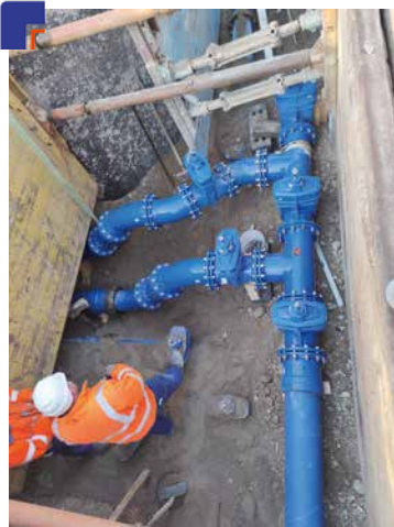
Für das Klinikum Großhadern installierte Ludwig Rieder die Feuerlöschtechnik
