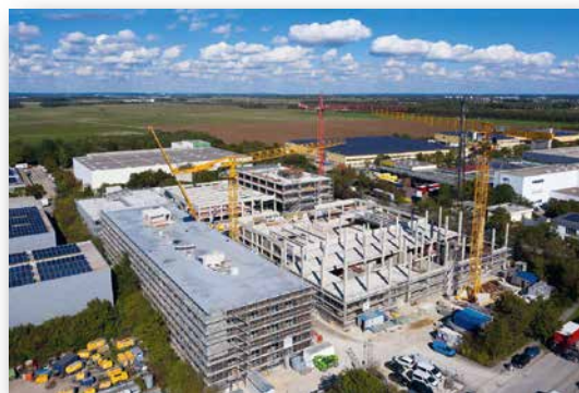
Ein Großprojekt von FUCHS in Garching über drei Gebäudeteile hinweg – aus einer Hand ausgeführt
