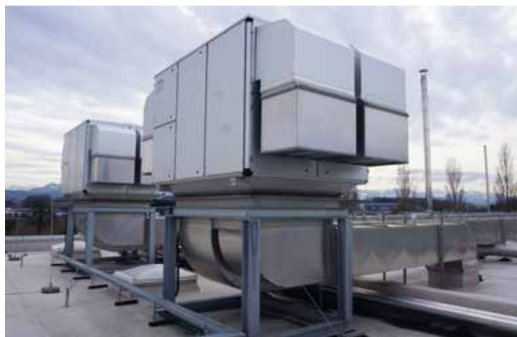
LK Lüftungsanlage REKU bei Fa. Miba in Roitham
