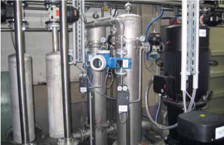
Die LK Ultrafiltrationsanlage, im Einsatz
