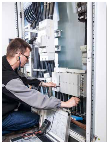
Technische Gebäudeausstattung ist eine Kernkompetenz von Rösler
