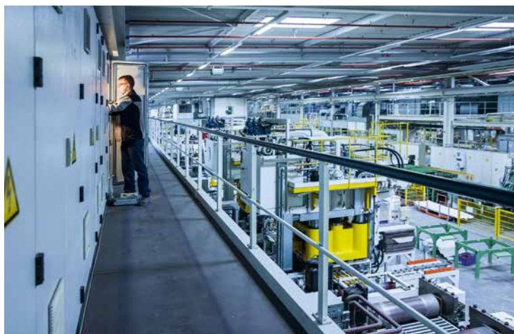
Bürogebäude, Montage- oder Lagerhallen, Rösler sorgt für die Elektrotechnik von Beleuchtung und Stromverteilung bis Einbruch- und Brandmeldeanlagen
