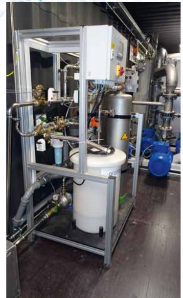
Die Pumpen-Tank-Einheit einer Wasserenthärtungsanlage
