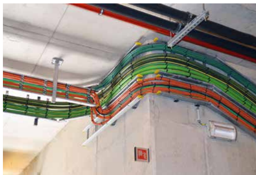
Die Kabeltragsysteme mit Funktionserhalt von Vergokan behalten ihre Tragfunktion auch im Brandfall
