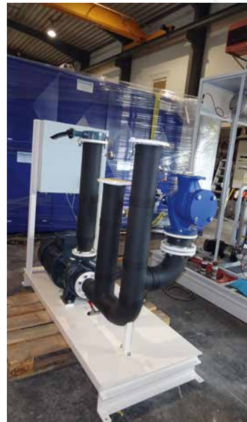
4 Bar-Pumpenstation mit einer Leistung von 65 m³/h
