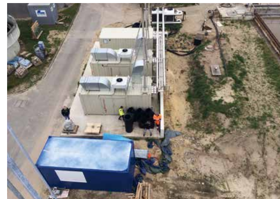
Die Kläranlage Winsen mit drei BHKW in Containern
