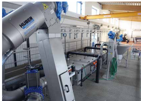
Die Kläranlage Lubmin mit einer Rechen-Sandfang-Kompaktanlage
